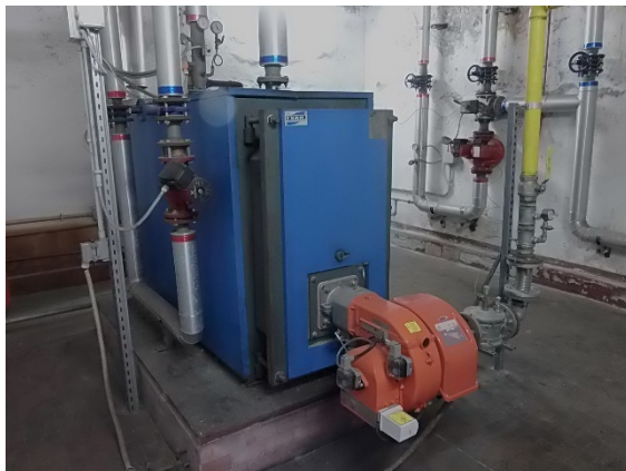
Figura 4.9 - Particolare centrale termica
