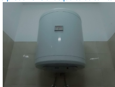
Figura 4.11 - Particolare del boiler elettrico per la produzione di acqua calda sanitaria
